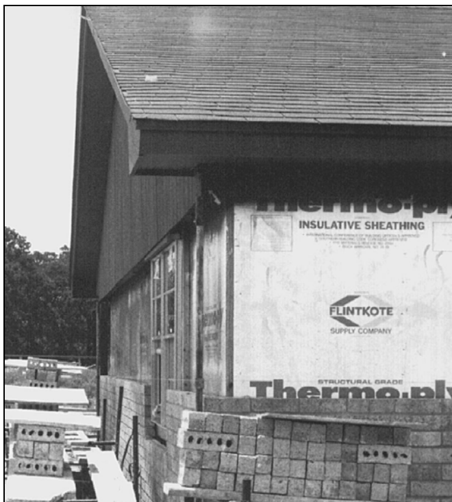
Рис. 7.32. В данном случае установлен и окрашен сайдинг фронтона до начала облицовки кирпичом
