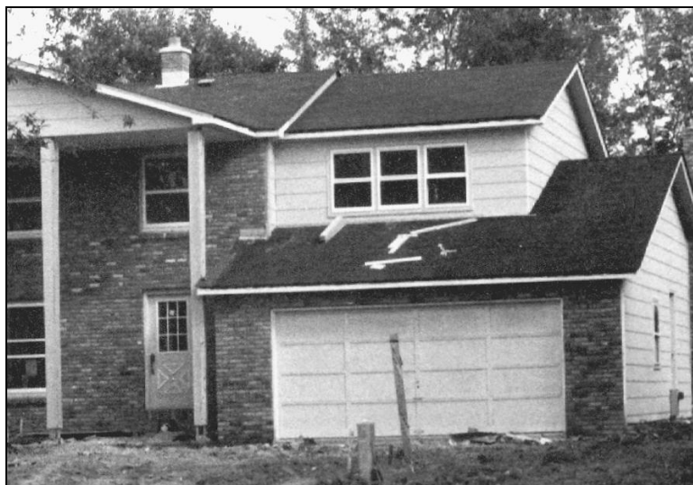
Рис. 1.6. Даже практически законченный дом и его неблагоустроенный участок могут оставаться опасными: обрезки досок на крыше, отсутствие крыльца за навешенной дверью, перекопанная территория и т. д.
