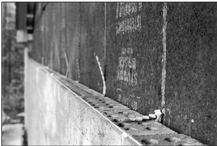
Рис. 7.65. Пластины помогают укрепить соединение кирпичной или каменной облицовки со стеной дома. Эти пластины прибиваются к стойками и «замуровываются» в раствор
