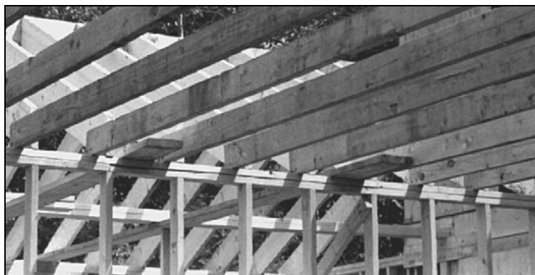
Рис. 4.87. Потолочные балки (лаги) опираются на брус обвязки стены. Сечения их прямоугольные, концы не скошены. Два гвоздя, забитые под углом, используются для скрепления лаг с брусом
