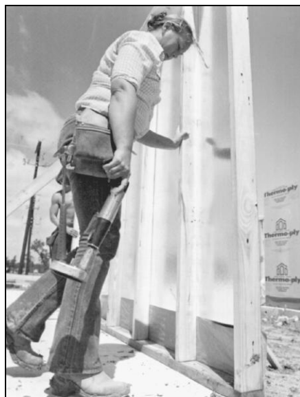
Рис. 3.37. Стеновые секции после подъема крепятся к бетонным плитам с помощью анкеров (Fox and Jacobs)
