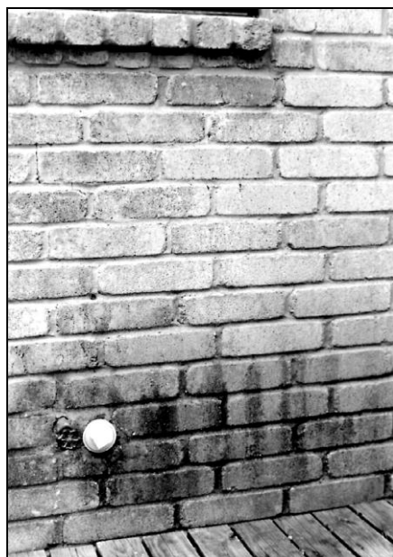
Рис. 2.17. Внешняя ревизия с заглушкой для прочистки трубы
