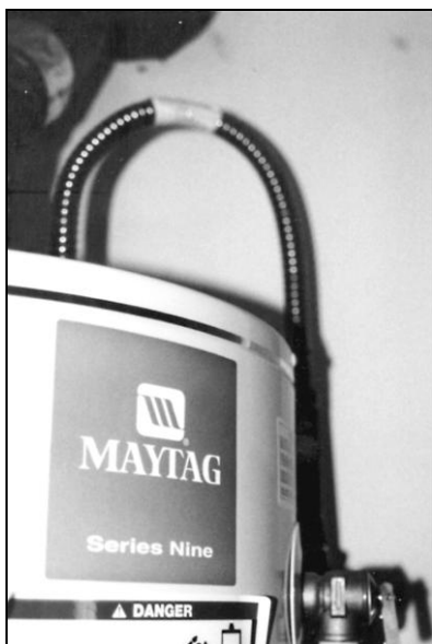
Рис. 7.61. Водонагреватель подключен с помощью гибких подводок и соединительных муфт
