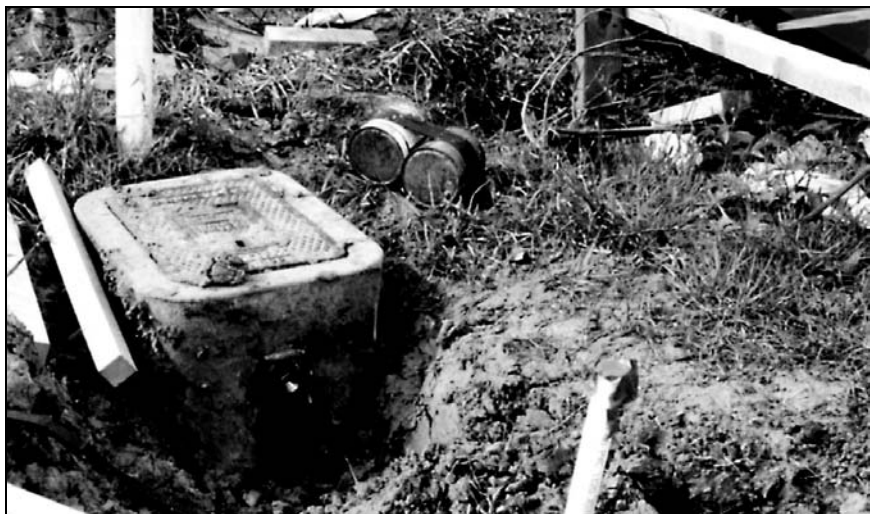
Рис. 2.18. Счетчик расхода воды, установленный в защитный бетонный корпус
